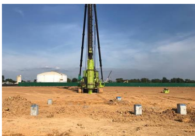
โครงการโรงไฟฟ้าบูรพาพาวเวอร์ (ประเทศไทย)
